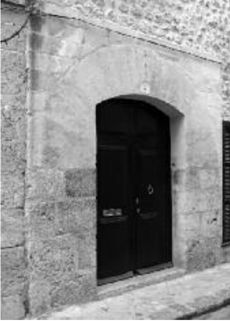
Portal rodó del carrer de Sant Bartomeu 5 (Sóller), amb l'arc de marès i els brancals de calcària juràssica. L'arc fou mutilat i convertit en un arc escarser en data indeterminada.
